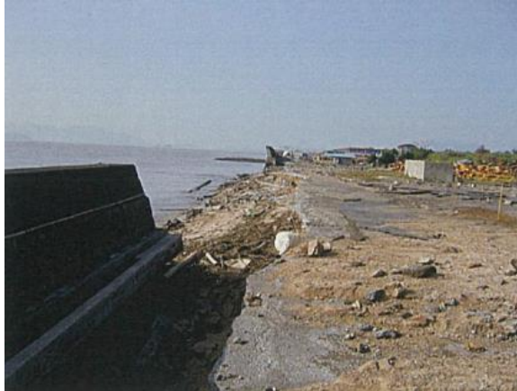
①平成16年台風18号による被害状況
