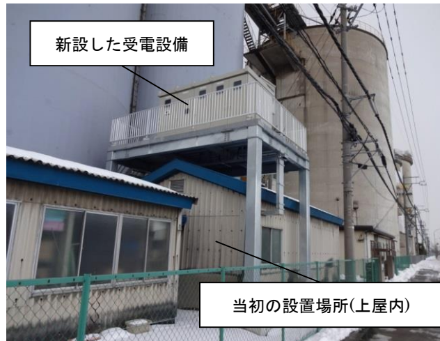
②当初の建物の上に受電設備を新規に 設置(基礎、柱、電気供給、受電設備)
