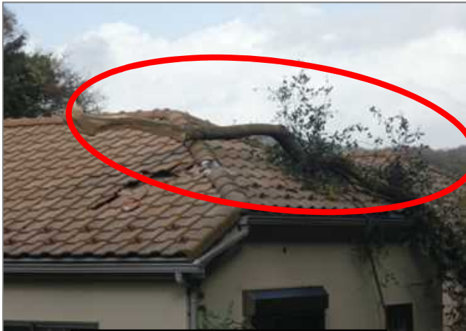
倒木による屋根の破損
