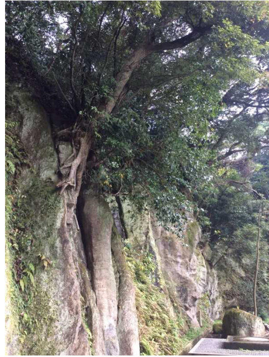
雨水が岩の間や表層土に浸透し、崩落する危険のある斜面地
