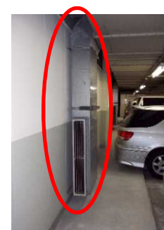
③排気ダクト及び吸込口
