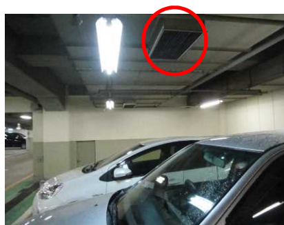
②給気ダクト及び吹出口
