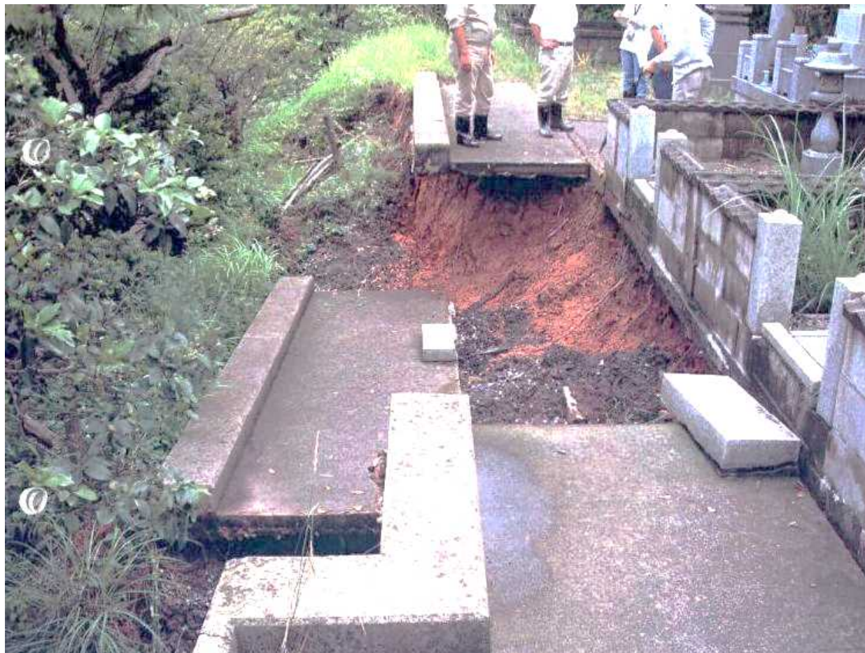
降雨による園路の被災
