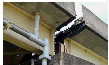
桁のずれ(開き 約30~40cm) ⇒橋梁を支える設備の設置作業中
