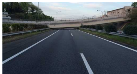
高速道路上に落橋
