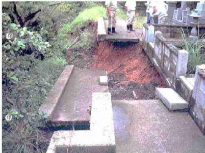
降雨による園路の被災
