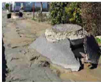
マンホールの浮上がり／千葉県香取市
