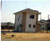
建物の傾斜被害／茨城県神栖市
