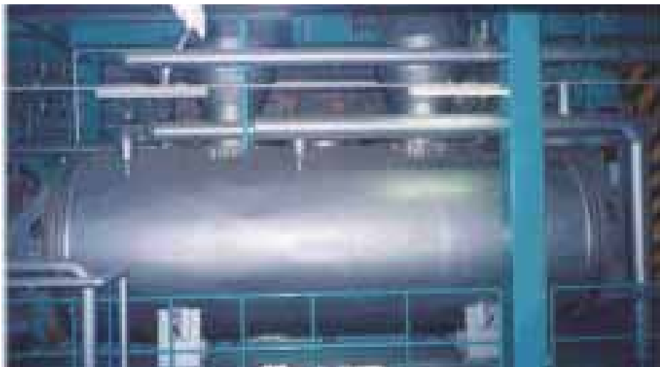
油温減圧乾燥装置(福岡県御笠川浄化センター)
