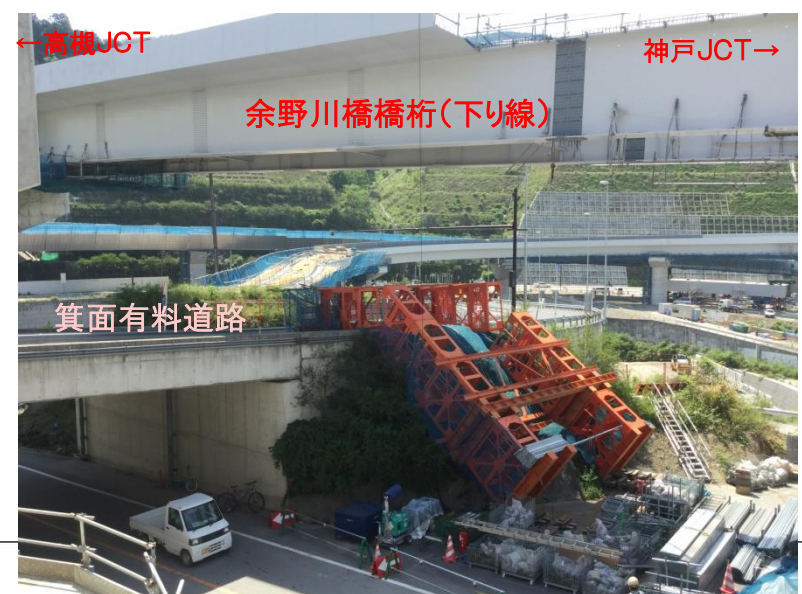
《余野川橋ベント転倒事故の状況写真》
