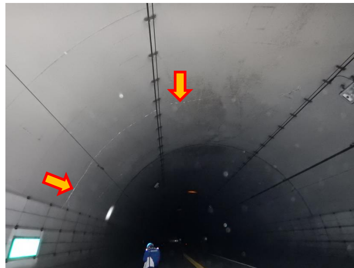
写真-2 覆エコンクリート輪切り状ひび割れ
