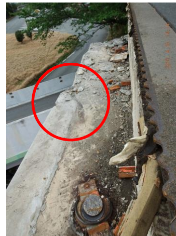
写真-4 斜角側橋座部に残された擦過痕
