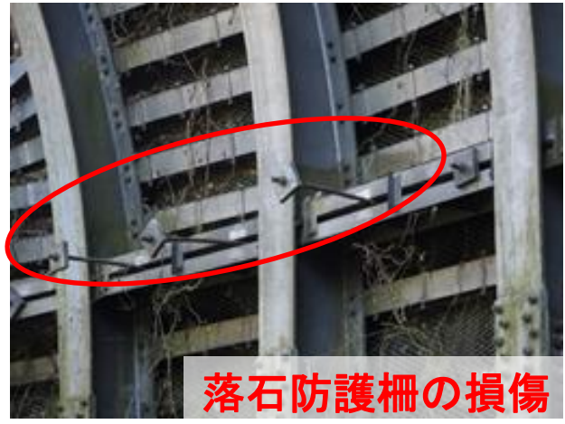
写真-2 防護工で対象としてない岩塊の規模により鋼製の落石防護柵が崩壊・損傷した
