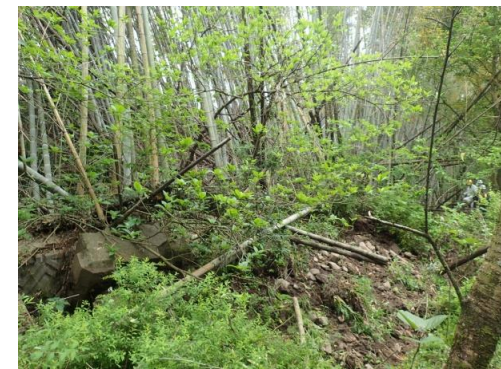
写真-6 竹林足元の水路の護岸ブロック積み擁壁の倒壊
