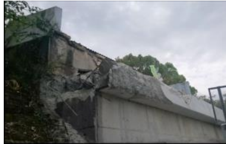
写真-3 横変位拘束構造の破壊
