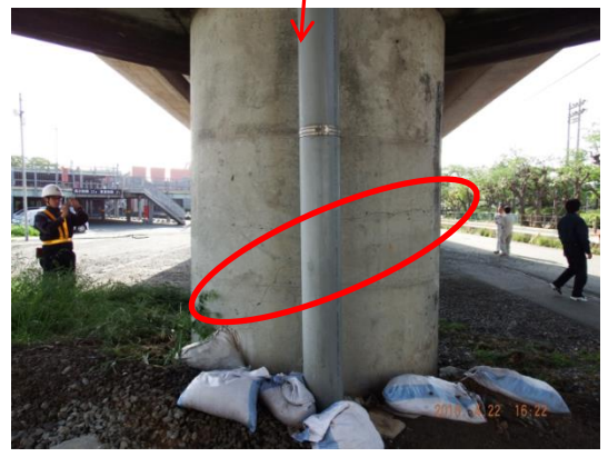
写真-2 曲げせん断ひび割れ
