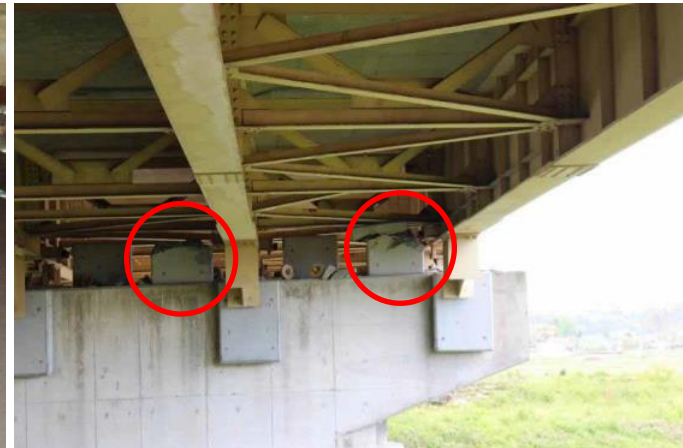
写真-3 変位制限構造の損傷(P21)
