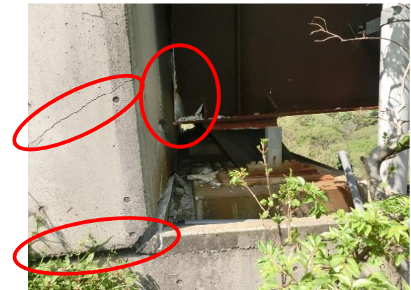
写真-4 橋台の損傷、支承部の残留変形
