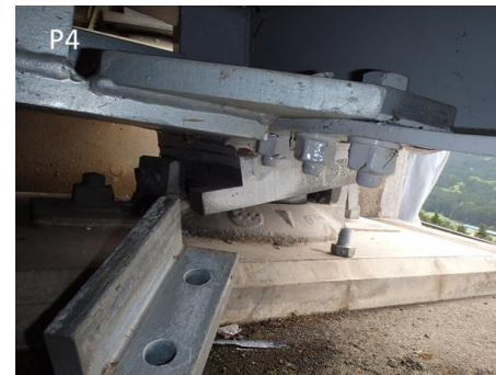
写真-4 支承の破損
