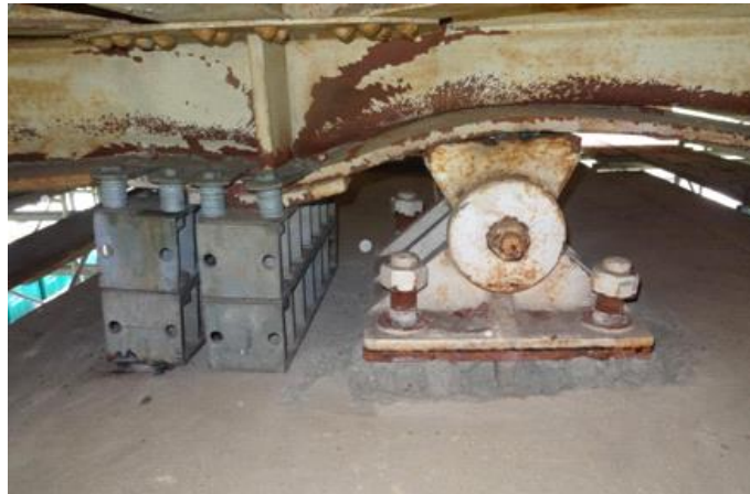
写真-2 支承部の損傷
