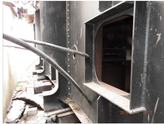
写真-2 落橋防止ケーブルの破断
