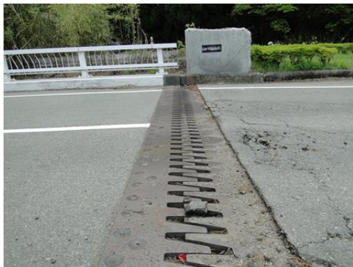
写真-2 A1橋台部分 (浮き上がりは生じていない)
