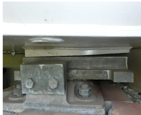
写真-3 支承部の損傷(A1)
