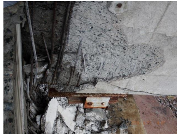
写真-3 A2橋台側桁端部の損傷
