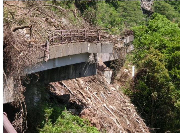
写真-2 橋梁の流出
