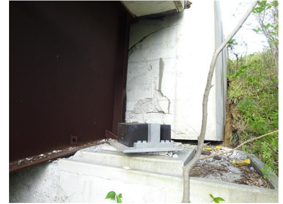
写真-1 橋台支承部、橋台の損傷
