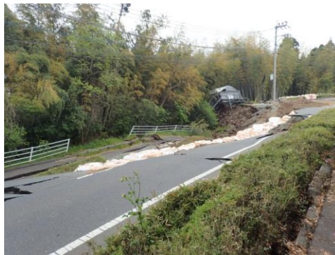
写真-3 小さな沢状地形上の盛土が崩壊
