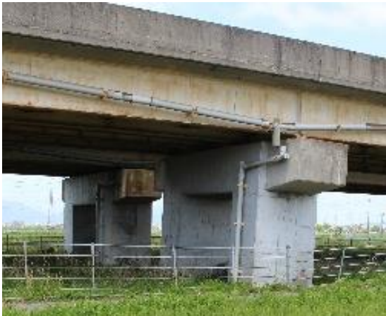
写真-1 橋脚の傾斜(P11)
