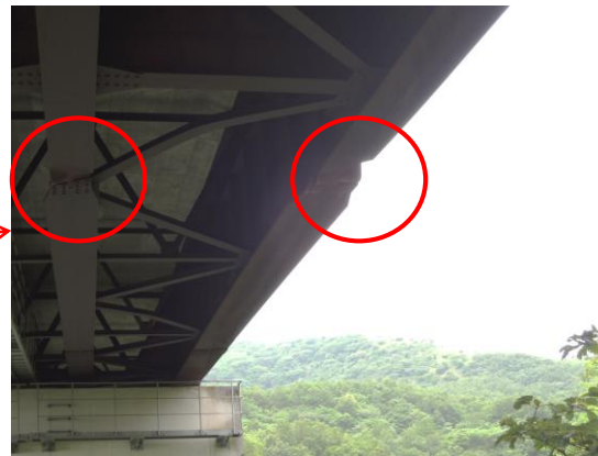
写真-3 主桁下フランジの座屈変形
