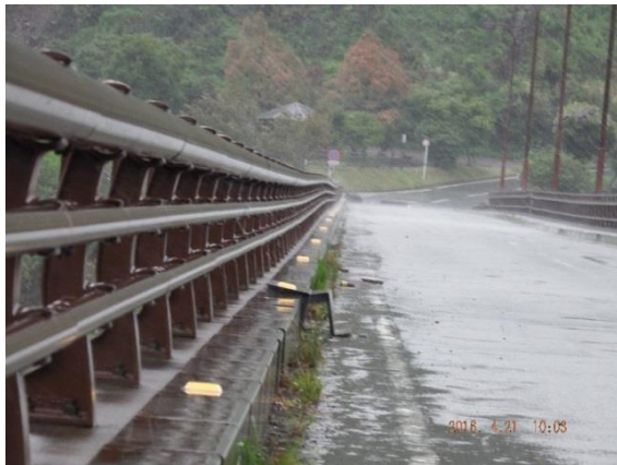
写真-2 上部構造の変形
