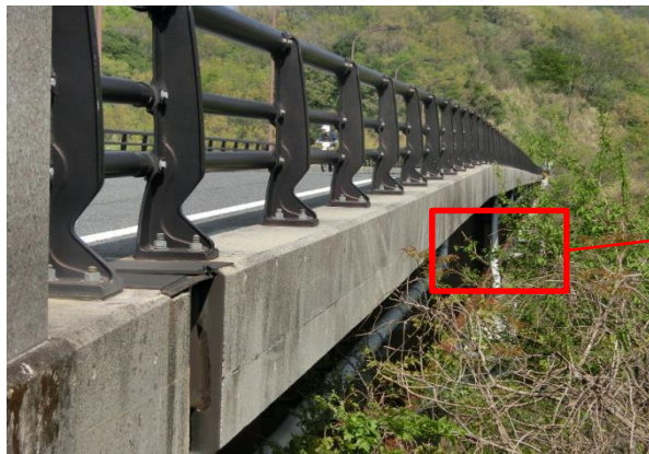
写真-2 桁の折れ曲がり
