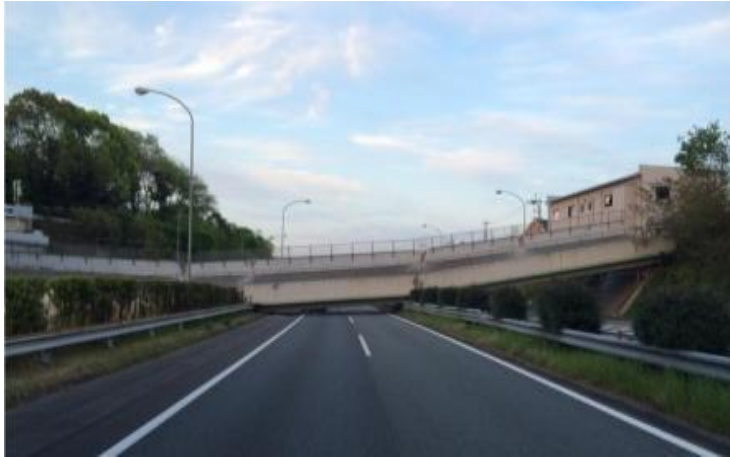
写真-1 落橋の状況
