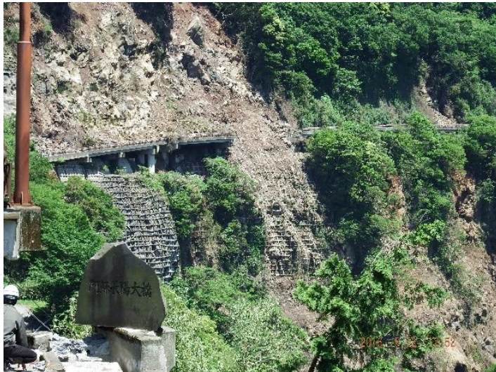
写真-3 斜面崩壊
