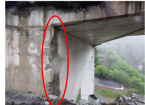
写真-4 A1橋台側上部構造と下部構造の衝突痕
