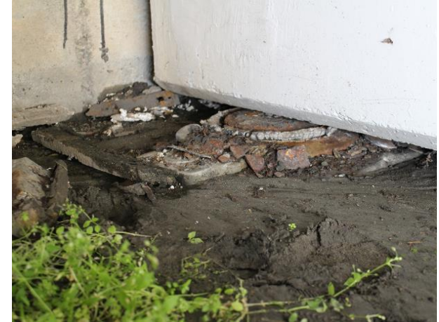
写真-1 支承部の損傷
