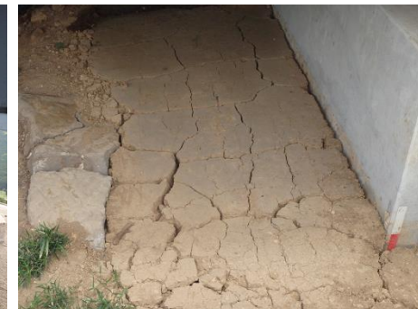
写真-5 橋脚の地際の隙間
