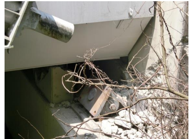
写真-4 支承部の損傷(A2)
