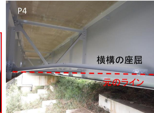
写真-3 横構の座屈
