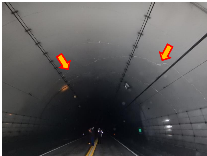
写真-1 天端付近のせん断ひび割れ
