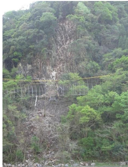
写真-1 強い地震動により道路から約50m上方を発生源として岩盤崩壊が発生し、岩塊が道路に堆積し、斜面下の河川にも落下した
