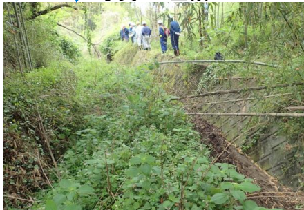
写真-2 沈下箇所の足元の水路の護岸ブロック積み擁壁は健全な状態
