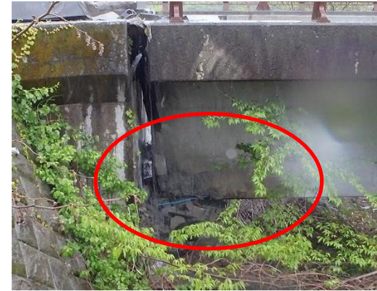
写真-1 A2橋台側桁端部の損傷
