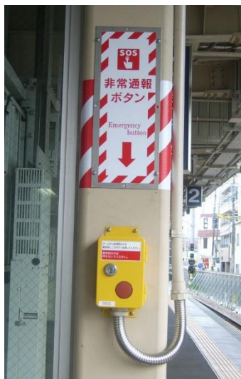
非常停止押しボタン
