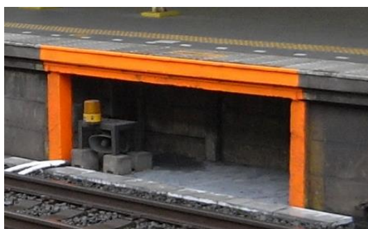
ホーム下の待避スペース
