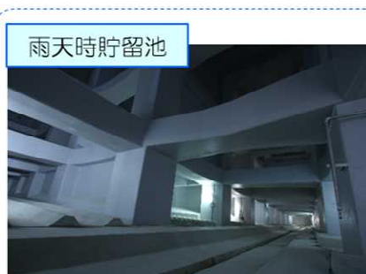
品川シーズンテラスの地下に整備
