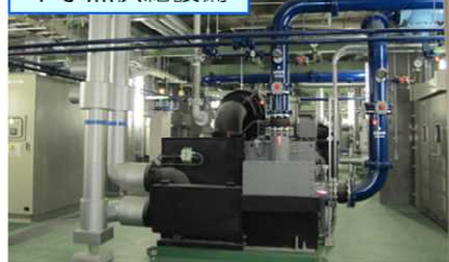
下水熱供給設備
