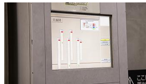
▲荷さばき場モニターでの貨物用エレベーターの運行状況の確認
