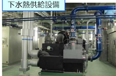
下水熱供給設備
