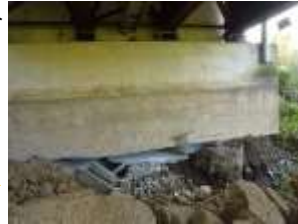
写真-1 橋台の沈下 (俵山大橋A1橋脚)
