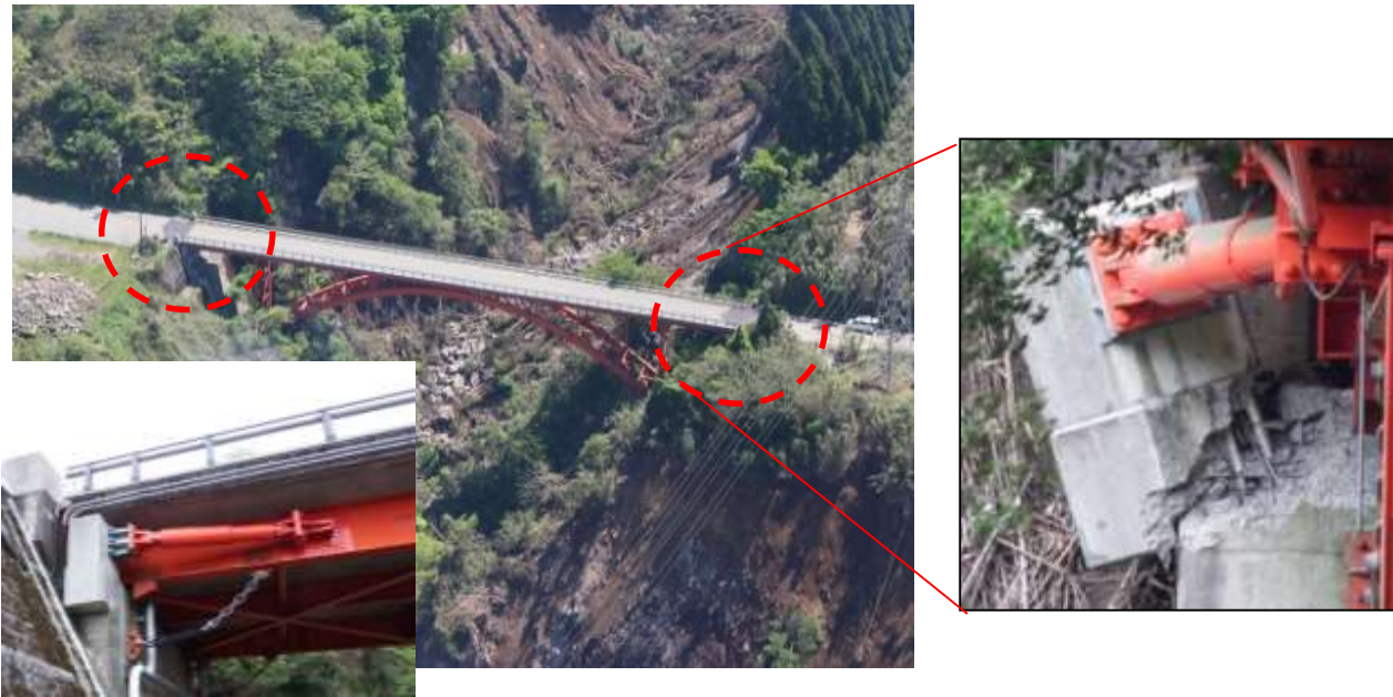
写真-1 制震ダンパー接合部(変位制限構造への取付) みなみあそ の損傷(国道325号・南阿蘇橋)
