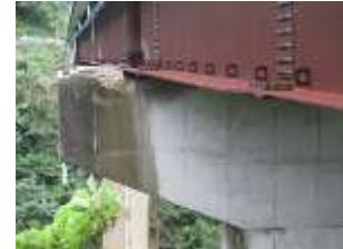
写真-2 ゴム支承の破壊 (俵山大橋P2橋脚)
