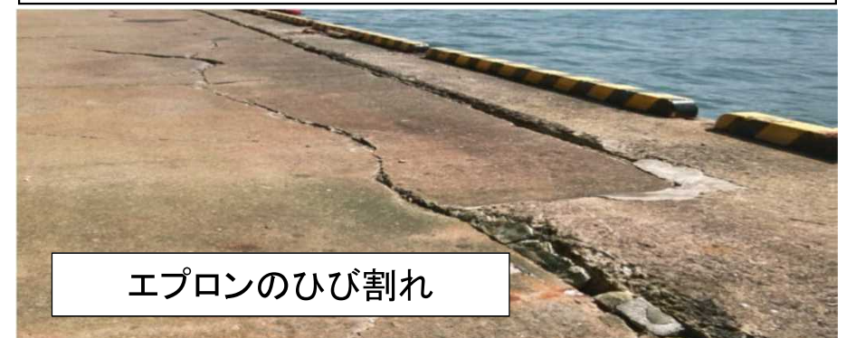
若浜南1号・2号岸壁の老朽化状況
