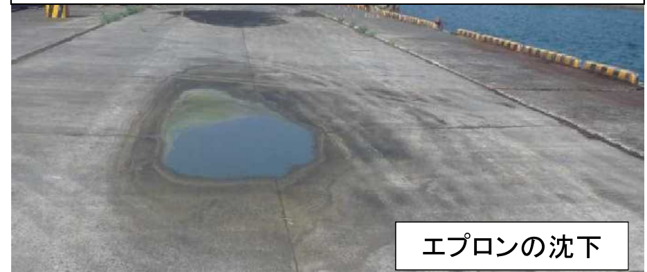
若浜中央5号岸壁の老朽化状況
