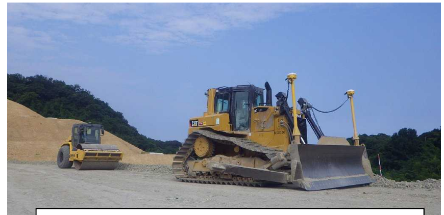
地場の測量機器メーカー等の連携により 後付け機器でICT施工を実施
