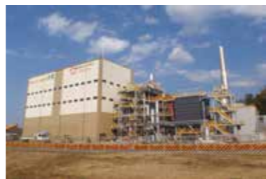
木質バイオマス発電所「多気バイオパワー」
