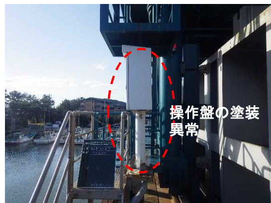
機側操作盤の塗装劣化の例
