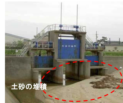
水門前面への土砂堆積の例
