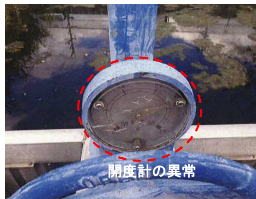
計器(開度計)の劣化の例
