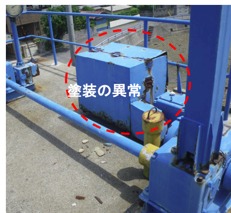
開閉装置の塗装劣化の例
