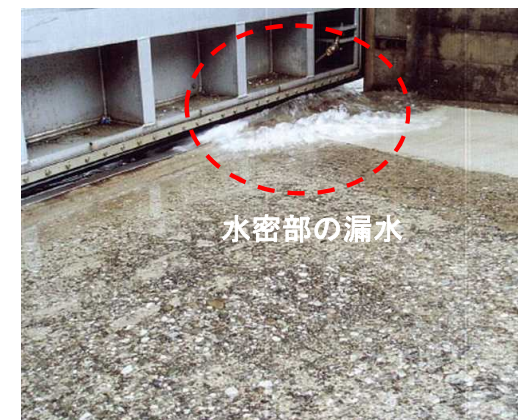
扉体底部からの漏水の例
