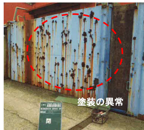
扉体の塗装劣化の例
