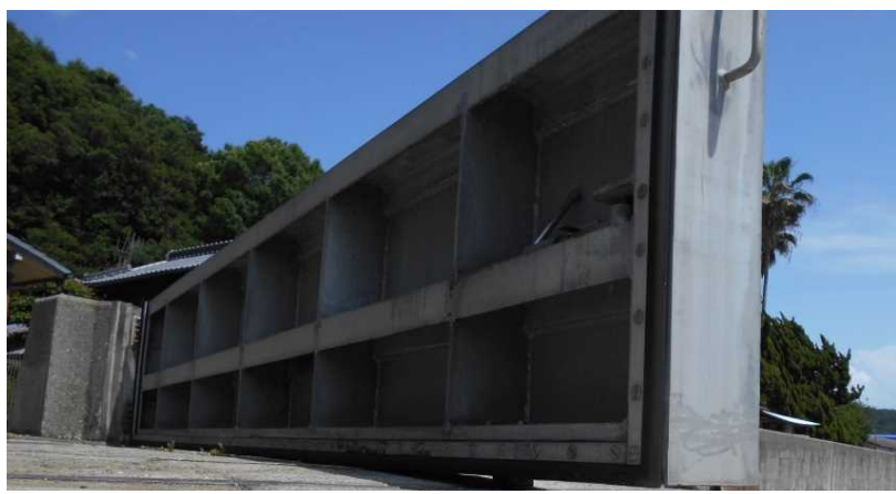
コンクリート床板の隆起による干渉(陸側より)
