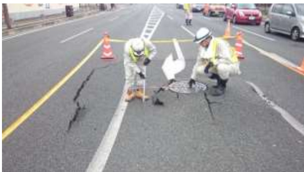
【緊急輸送路内陥没】
