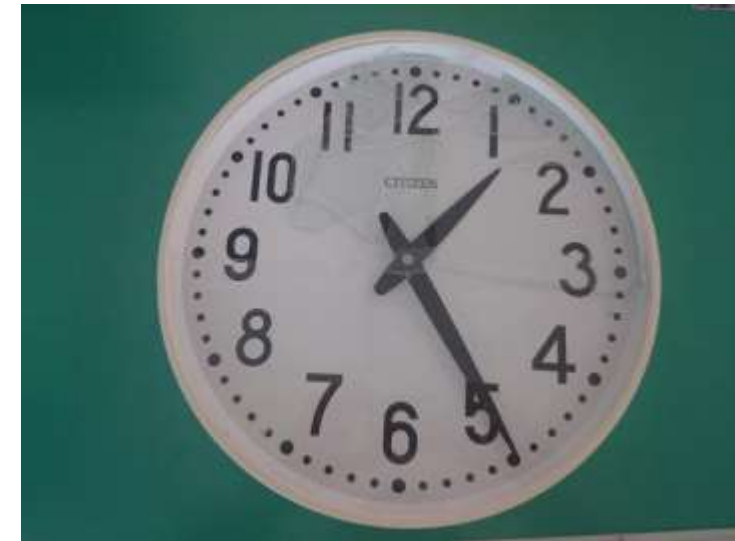
落ちて破損した掛け時計 3
