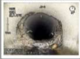
⑦29.78 破損・進入不可
