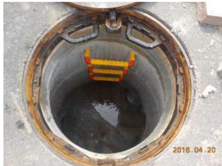
マンホール内部(滞水)
