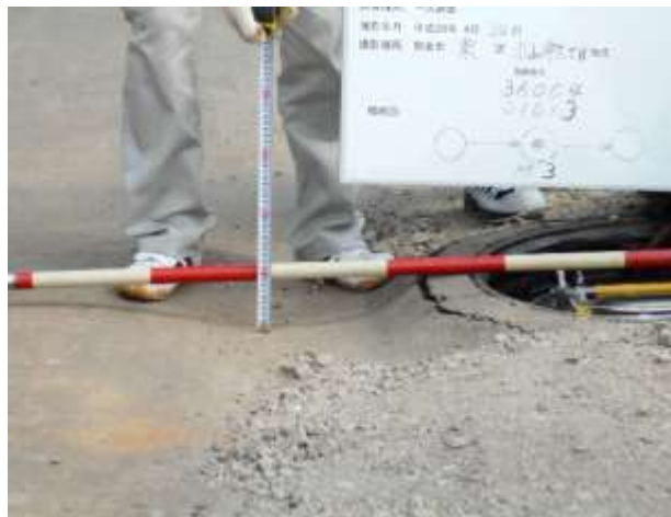
道路陥没(高さ100mm)
