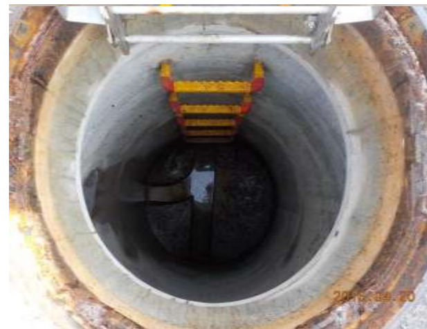
マンホール内部(滞水) 17
