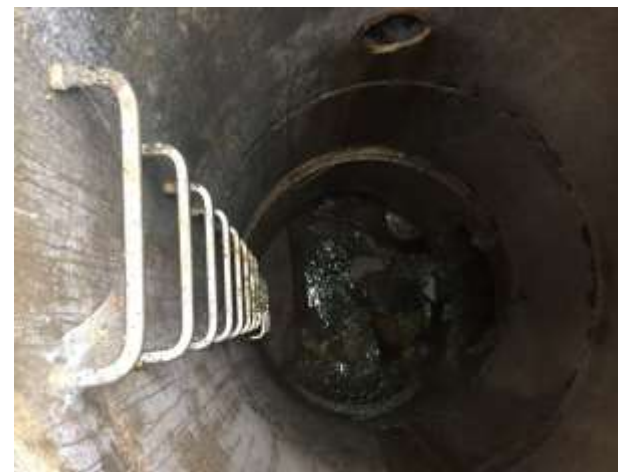
マンホール内部(破損)
