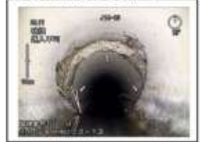
⑥28.11 破損・進入不可
