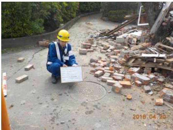
被災状況写真
