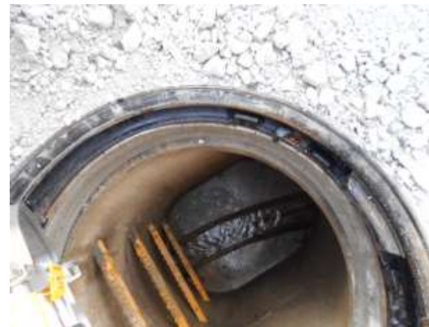
マンホール内部(ズレ)
