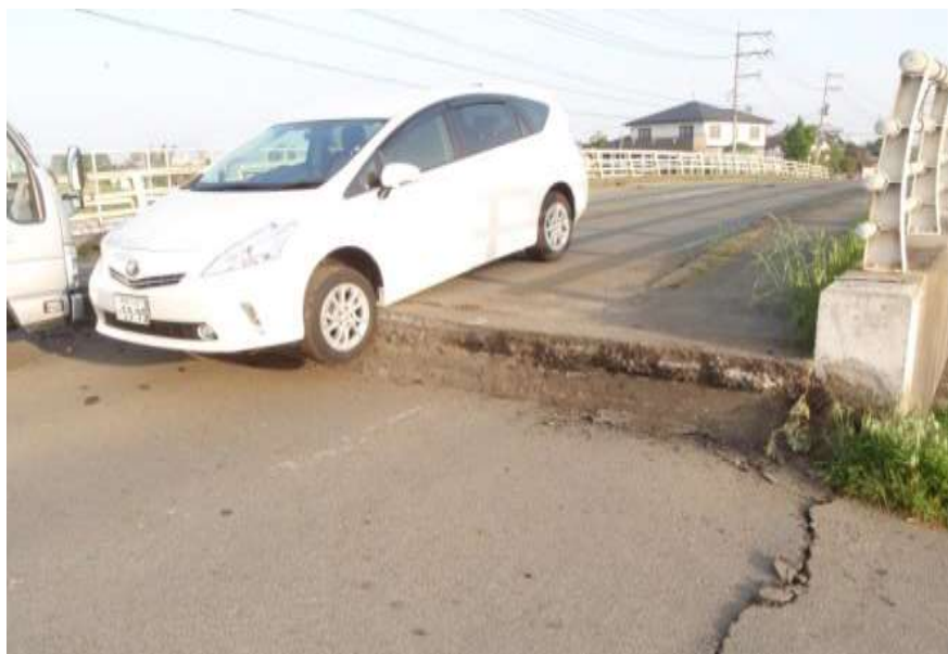
橋梁との路面段差
