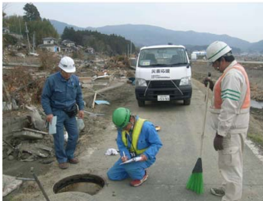
左：被災調査状況（岩手県大船渡市）
