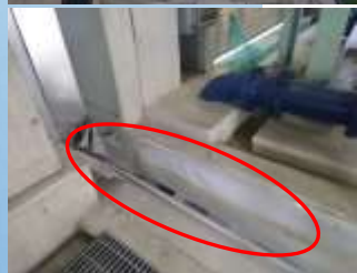
基礎部分の破損
