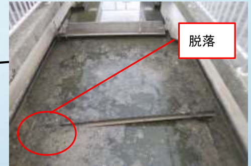
最初沈殿池汚泥掻き寄せ機破損
