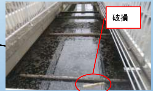
最終沈殿池汚泥掻き寄せ機破損
