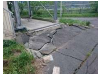
場内道路陥没状況
