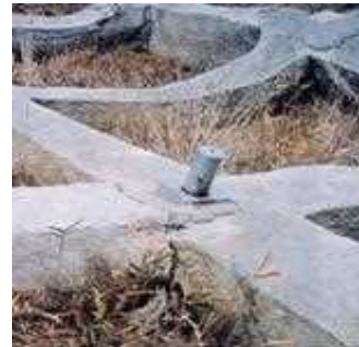
受圧構造物の破損の例
