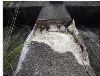
法枠工の老朽化損傷
