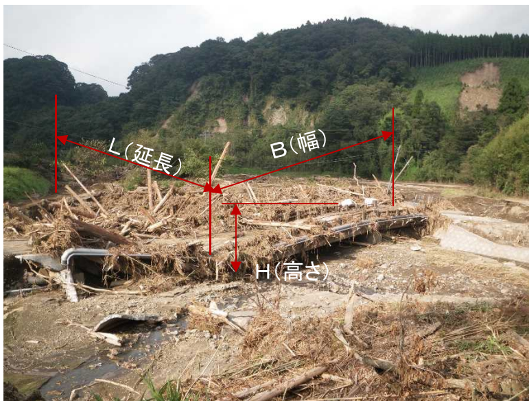
流木等の堆積状況の例
