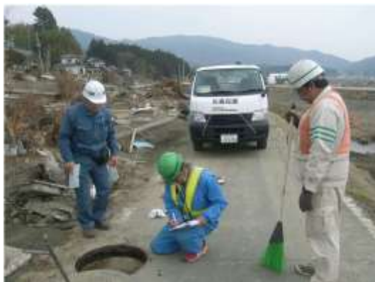
被災調査状況 (岩手県大船渡市)
