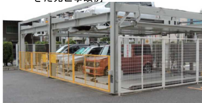
写真 外部者の侵入を防ぐ前面ゲートと柵の設置例
