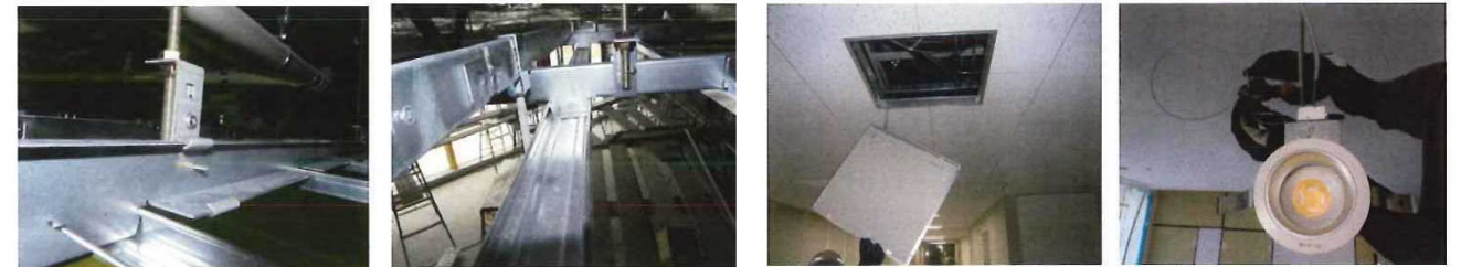
写真—クリップを使用しない天井下地工法 写真—天井下地と天井に付く部材をワイヤーで固定
