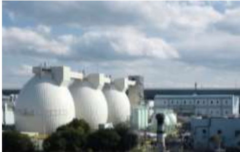
下水汚泥メタン発酵施設
