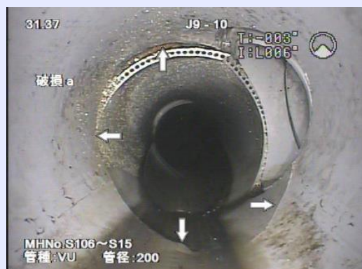
破損A(管路)
