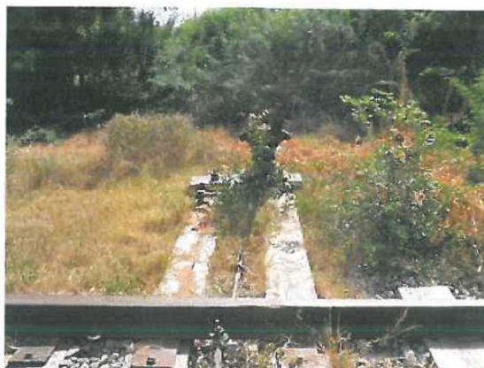
写真 2-12 P22 号分岐器転換装置
