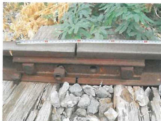
写真 2-6 継目板ボルトの抜け・緩み
