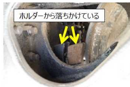
写真11 脱落しそうな制輪子
