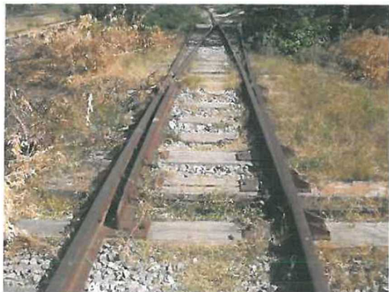
写真 2-11 P22 号分岐器全景
