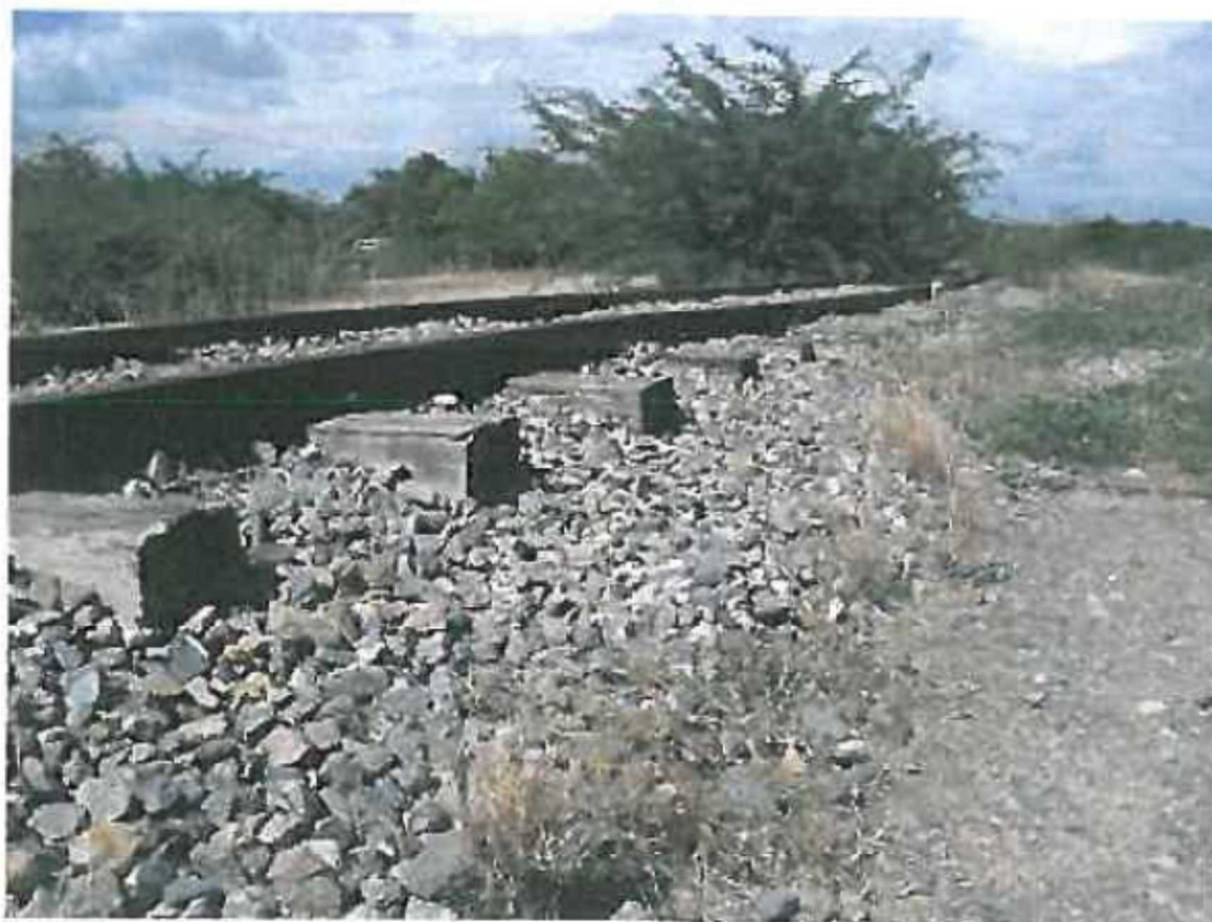
写真 2-10 道床(まくらぎ端部)不足
