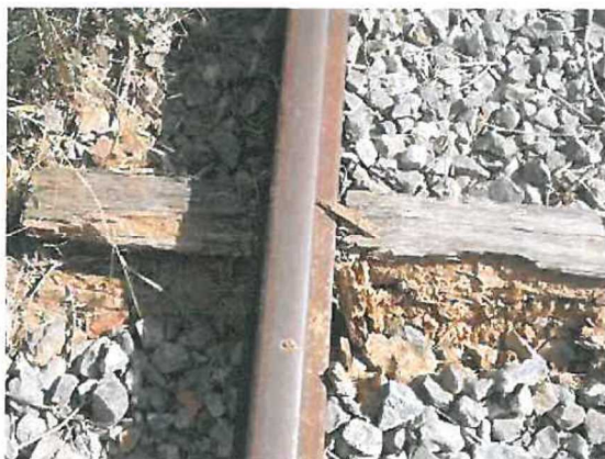
写真2-7 まくらぎ腐朽
