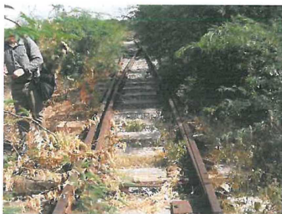
写真 2-13 P23 号分岐器全景
