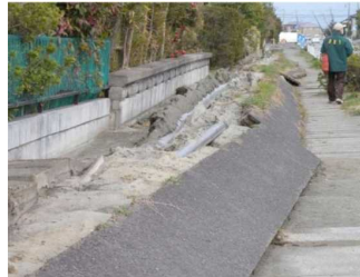
宅地の液状化被害
