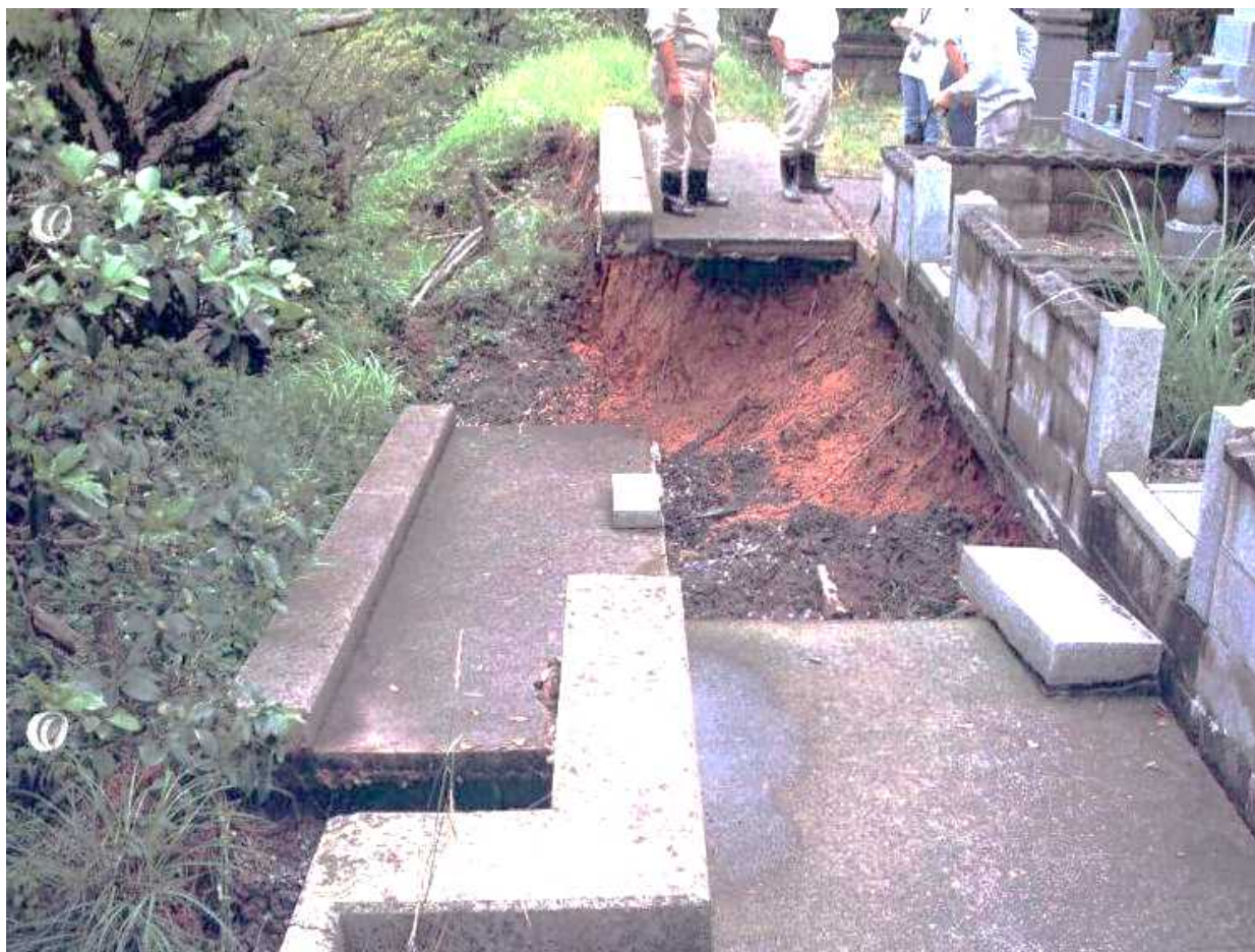
降雨による園路の被災
