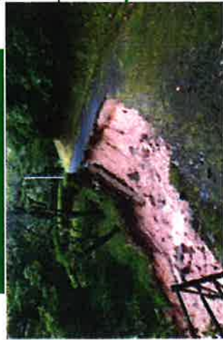
法面崩落(立入禁止措置済)
