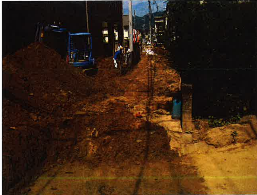
市が宅地内土砂を撤去しているところ（広島市安佐北区口田地区）
