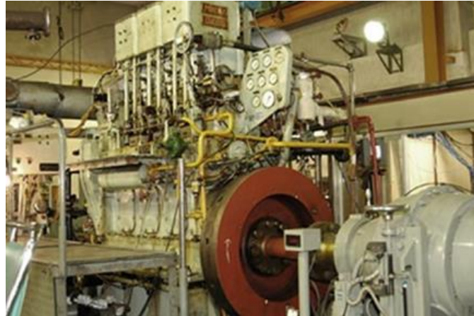
図 3-7 エンジン外観
