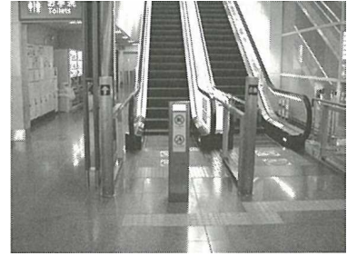
写真2 エスカレーター
