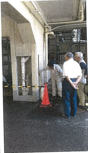
213号室系統の柱内部の給水管
