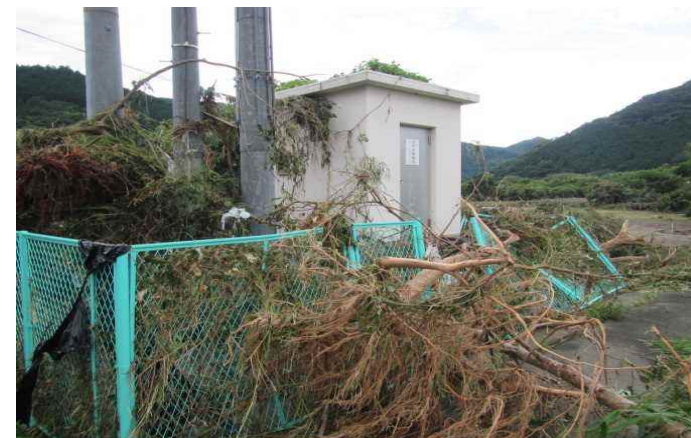
放流警報設備の浸水後の状況
