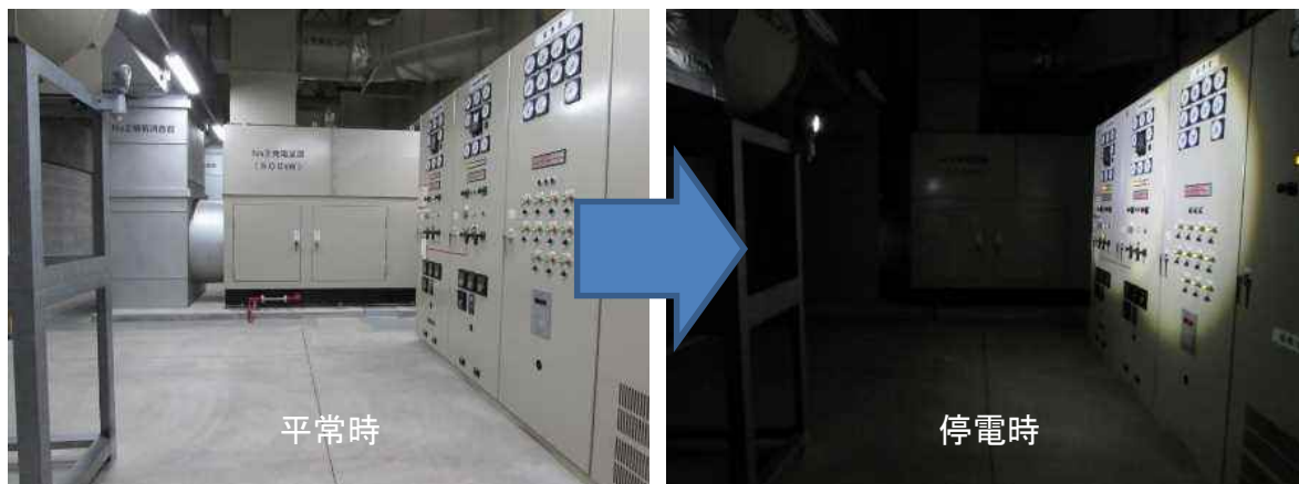
停電時の機械室の状況(イメージ)
