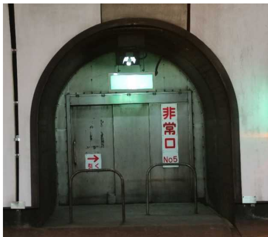
避難通路入口のイメージ (山岳トンネルにおける避難連絡坑の例)
