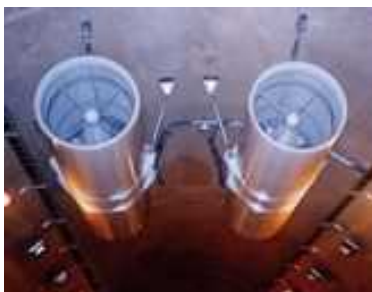
常時の換気方式に左右されない排煙能力を確保
