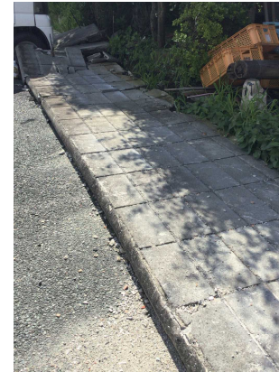
地震によりブロック塀が倒壊
