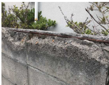
割れや鉄筋の露出がみられる塀
