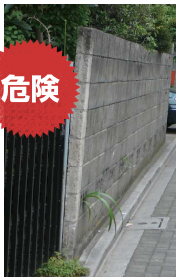
傾いている危ない塀
