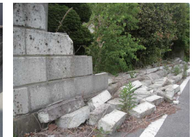
地震により石塀が倒壊
