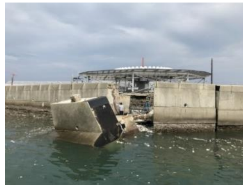
<一部護岸の転倒>
