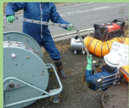
下水道管路点検支援技術
