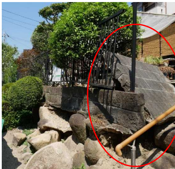
【現行基準に適合しないブロック塀の被害】
