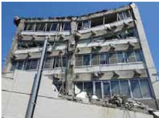
【旧耐震基準の建築物の被害】
