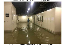
地下電源設備の浸水被害
