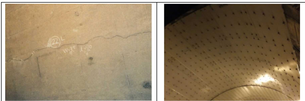
損傷部の写真
