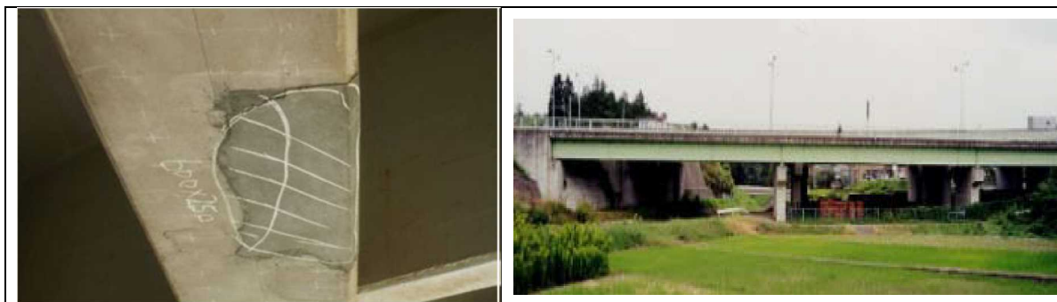
損傷部の写真
