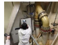
排水監視記録装置
