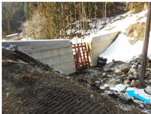
土石流発生前 (R4年3月)
