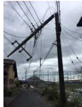
電柱の倒壊による配電設備の故障 （9/9撮影 千葉県多古町提供） （災害時気象報告より）
