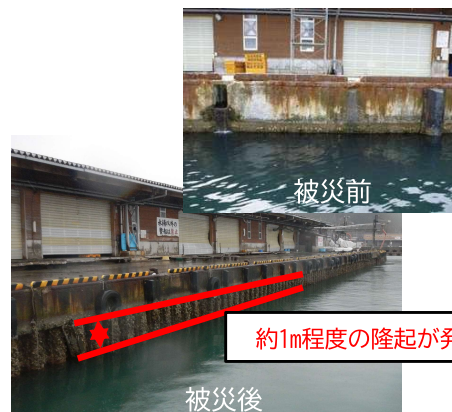
船だまりの被害状況
