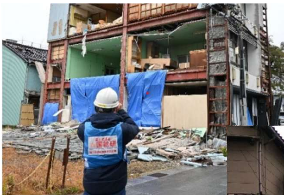
建築物の損壊状況（七尾市）
