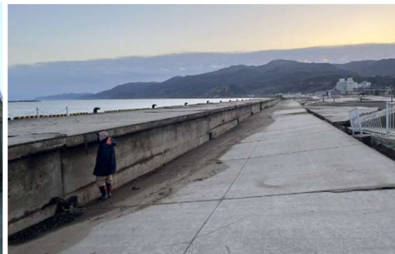
輪島港の被災（輪島市）
