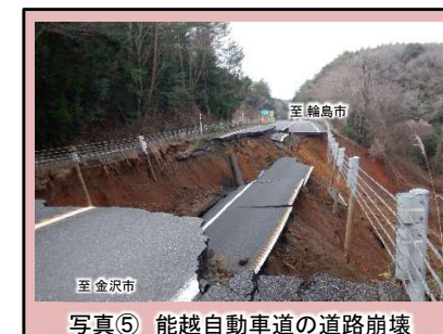
写真⑤ 能越自動車道の道路崩壊
