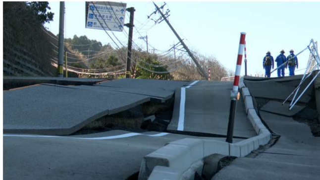
国道249号道の駅千枚田付近（輪島市）
