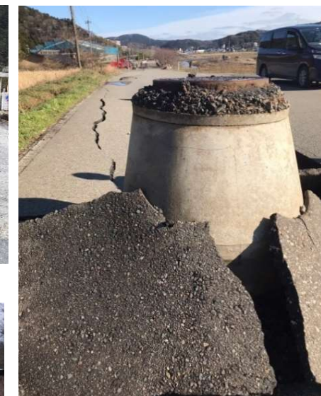
下水道マンホールの浮き 上がり（輪島市）
