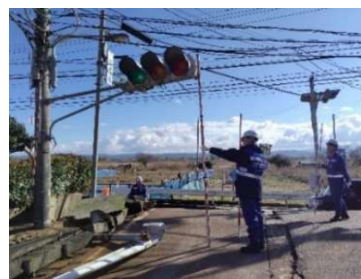
道路の被災状況調査 （石川県内灘町）
